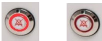
Abbildung 14.1 Alarmtaste, die den Alarmzustand anzeigt
